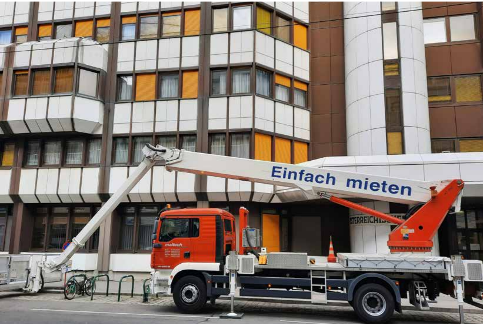
Alles in bester Ordnung: Die Dachinspektion konnte erfolgreich abgeschlossen werden. Wartungsarbeiten gehören zu den Routinetätigkeiten der PVD.
